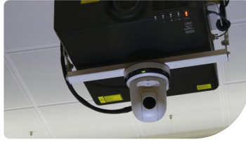
IPC-001 - la principal sala de conferencias del WHU
