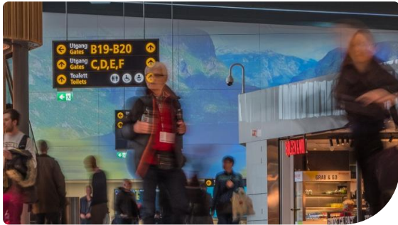
Instalacja w strefie operacyjnej, na którą składają się trzy projektory laserowe RZ31K
